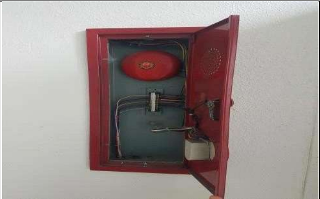
2. 과학관 2층 2-2번 발신기 감지기 선로 12V(저전압)로 동작
