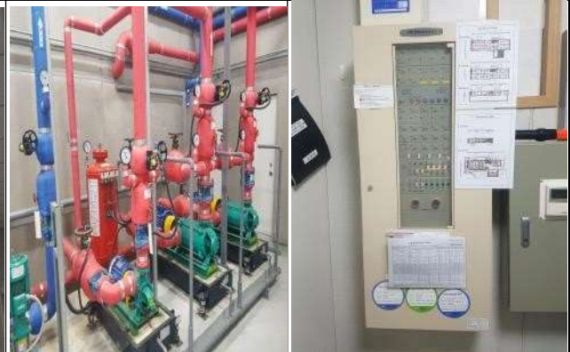
8. 강의동 지하1층 펌프실 주펌프 및 예비펌프 압력스위치에 의해 자동으로 정지 보수
