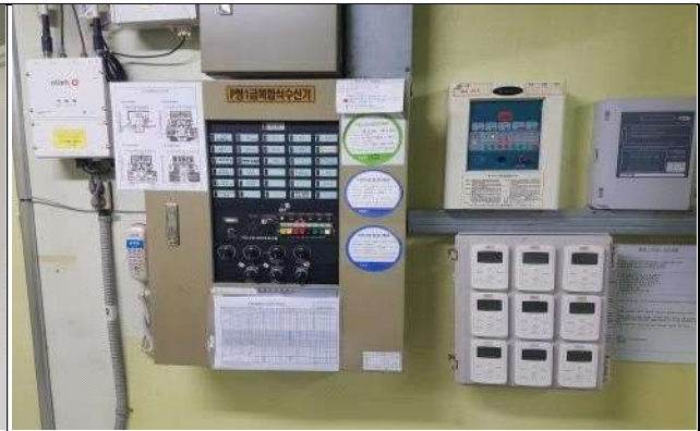
6. 도서관 지하1층 수신기 3층 전용수신기 동작시 주수신기에서 확인 보수 (선로 분리해 놓은 상태임)
