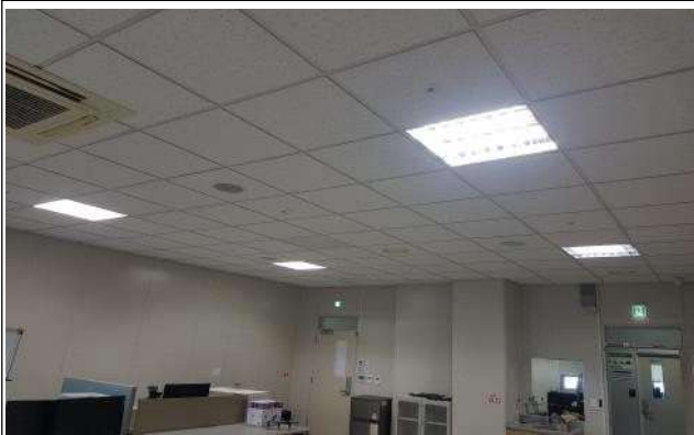
7. 연구동 4층 410호 출입구쪽 스프링클러 헤드 살수반경 초과 증설 (2개소)
