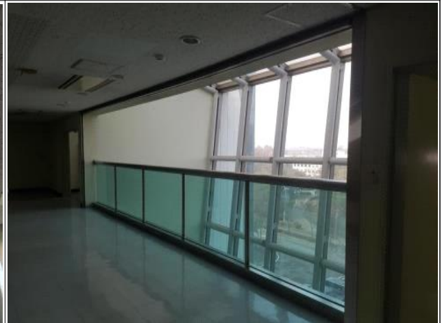
10. 중소벤처육성지원센터(4F) : 중앙계단 방화셔터 하단 리미트 조절요함
