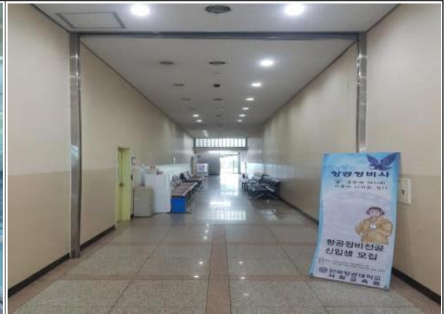
8. 항공우주센터(1F) : 방재실 앞 복도 방화셔터 수동기동 불량
