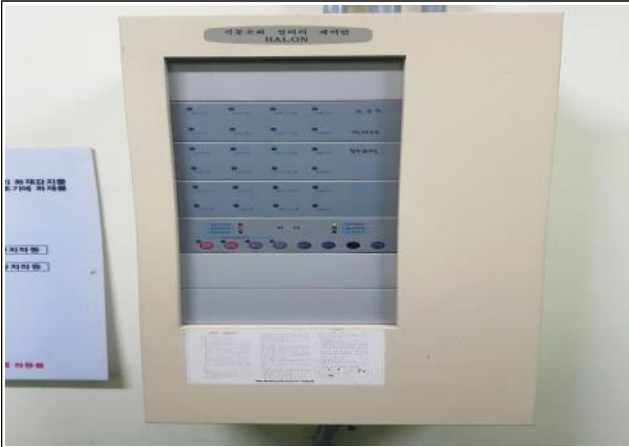
1. 기계관(B1F) : 전기실 A감지기 수신기 확인 불가
