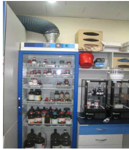
올바른 예. 배기구가 설치된 시약보관함
