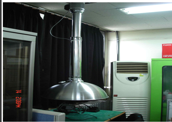
납땀 작업공간에 국소배기장치 설치
