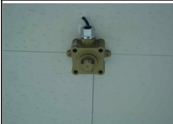
가스 누출감지기 설치(감지부)
