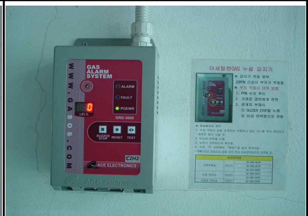
가스 누출감지기 설치(수신부)
